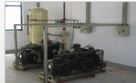
H P AIR COMPRESSOR 高压空压机
