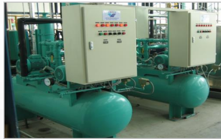
vacuum system 真空系统
