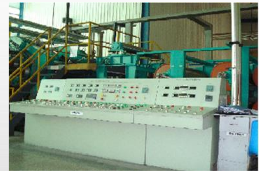
Controlling Platform 控制台
