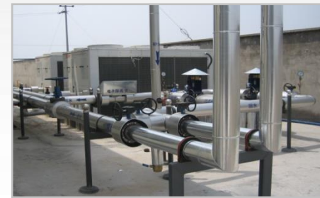
Colling System 冷却系统
